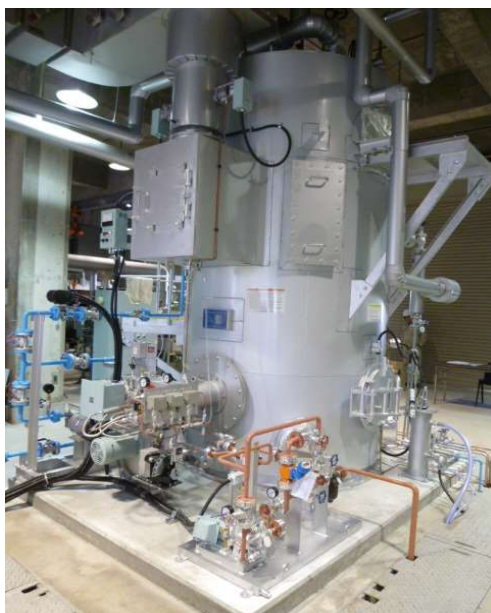
第3実習実験棟 ボイラ実習室
