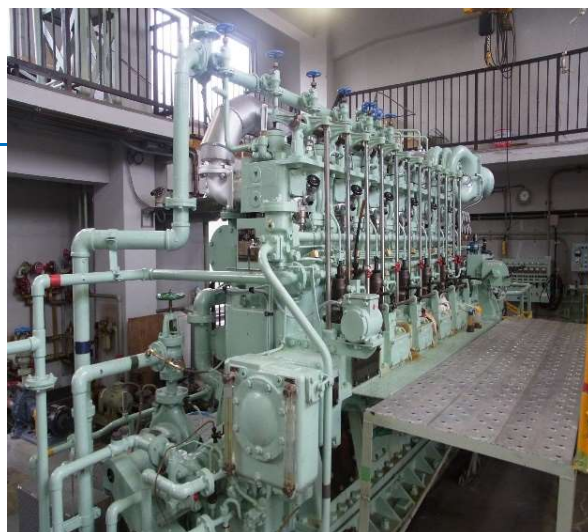
内燃機関実習実験室
